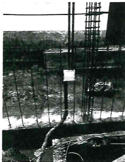
COMUNICACIONES: Canalización Puesta de Caja y Tuberías entre Bloque D y E Exteriores Piso 1
